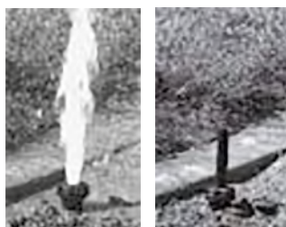
Sin el dispositivo de cierre de caudal
